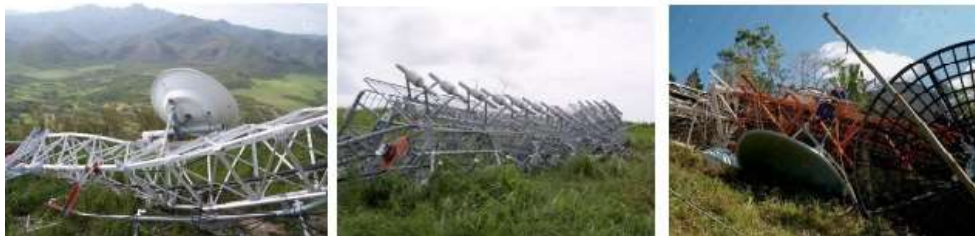
Figura 2 Fallo de torres de telecomunicaciones con presencia de antenas (Martín, 2012)
